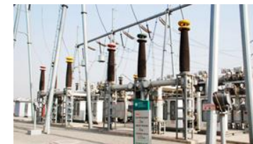
变电站无人值守监控
