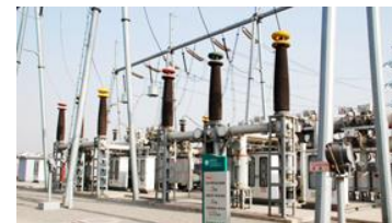
变电站无人值守监控
